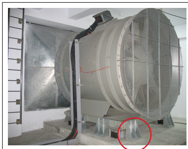
YS-270EA 安裝於雪山隧道大型風機
