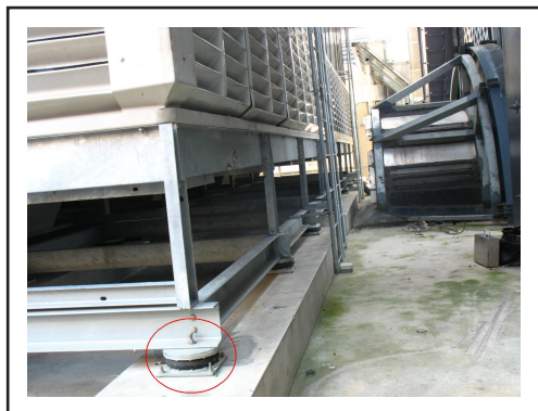
水塔安裝YS-K氣墊式避振器
