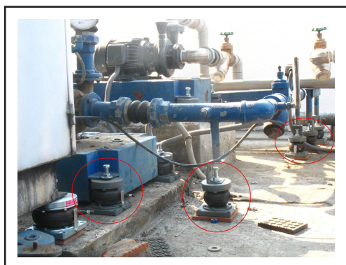
管路安裝YS-K氣墊式避振器
